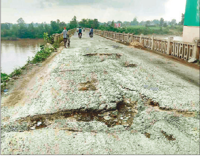
पुल की जर्जर सड़क।
